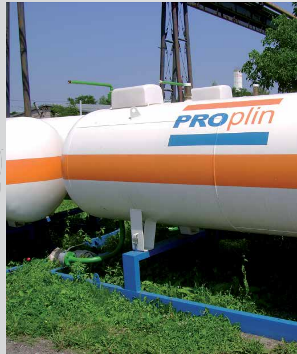
PROJEKT: NADZEMNI PLINSKI REZERVOARJI IZVAJALEC: "ĐURO ĐAKOVIĆ" ZAVARENE POSUDE, SLAVONSKI BROD
